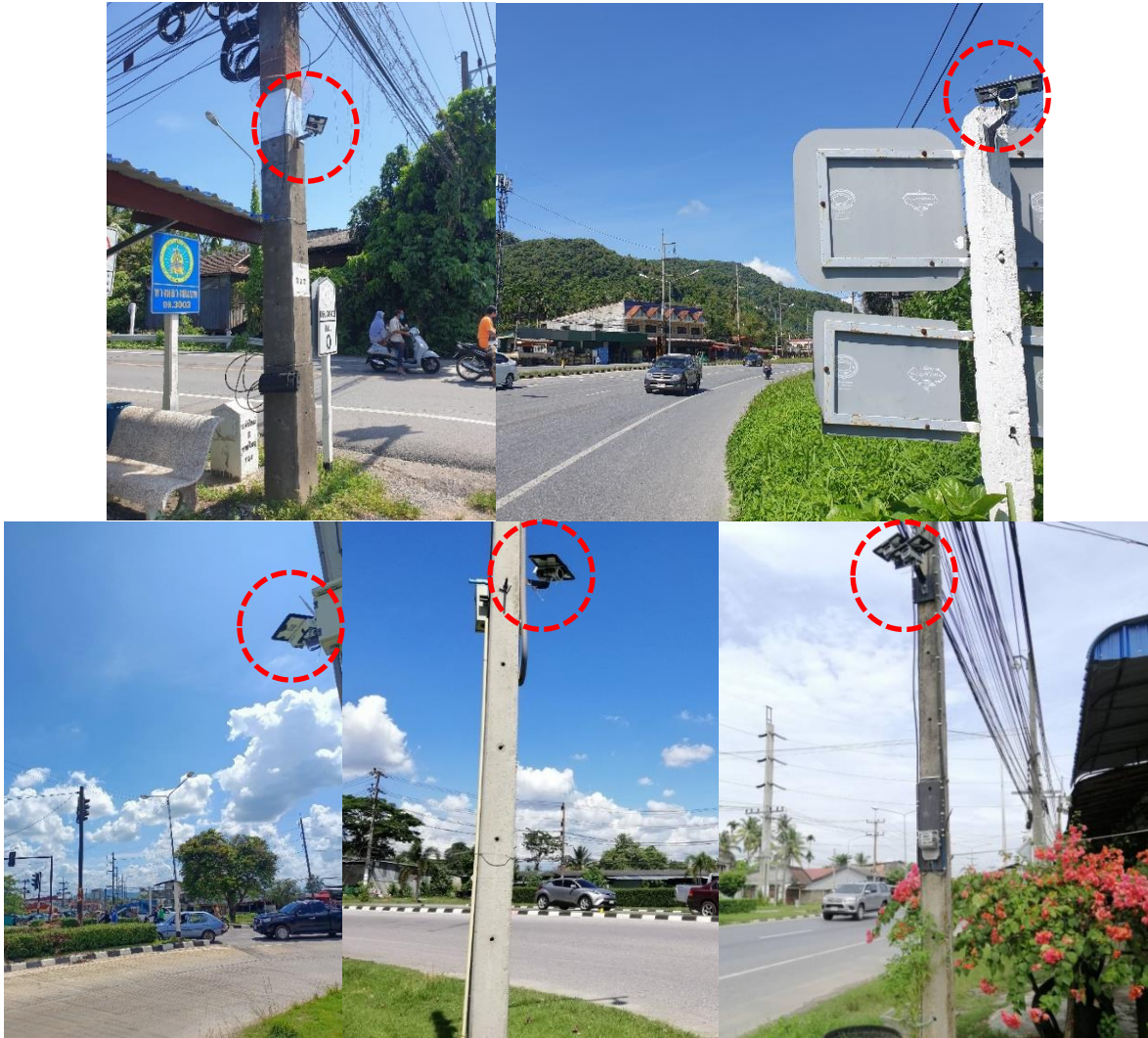
รูปที่ 3.3-6 การติดตั้งกล้องวงจรปิดสำรวจปริมาณจราจรที่ทางแยก
