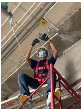
รูปที่ 5 การใช้งานอุปกรณ์ป้องกันภัยส่วนบุคคล (Personal Protective Equipment) ที่ถูกต้องเหมาะสมในงานเดินท่อร้อยสายระบบไฟฟ้าแรงต่ำ
