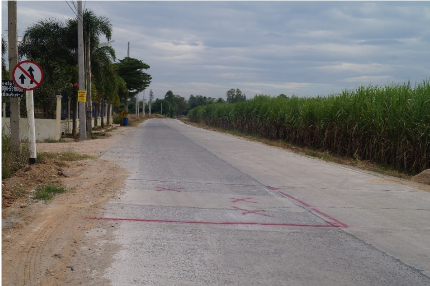
รูปที่ 1 สภาพถนนก่อนการซ่อมบำรุง
