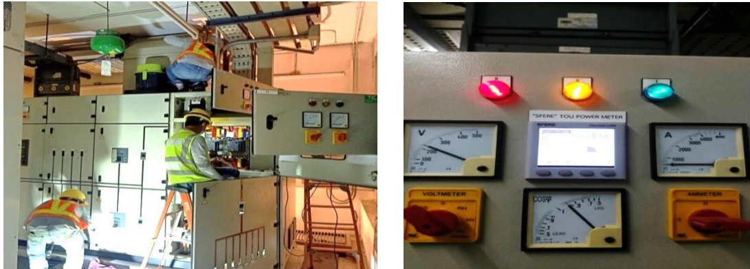
รูปที่ 3 การดำเนินงานติดตั้งติดตั้งอุปกรณ์วิเคราะห์การใช้พลังงาน (TOU Power Meter) เพื่อตรวจสอบการใช้พลังงานของระบบภายในอาคาร
