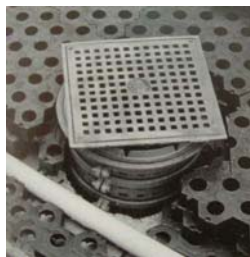
ภาพ 10 แสดงฝาช่องท่อกลม (Round drain หรือ Deck drain) ควรเรียบเสมอกับผิวบนของชั้นระบายน้ำ (Theodore Osmundson, 1999)
