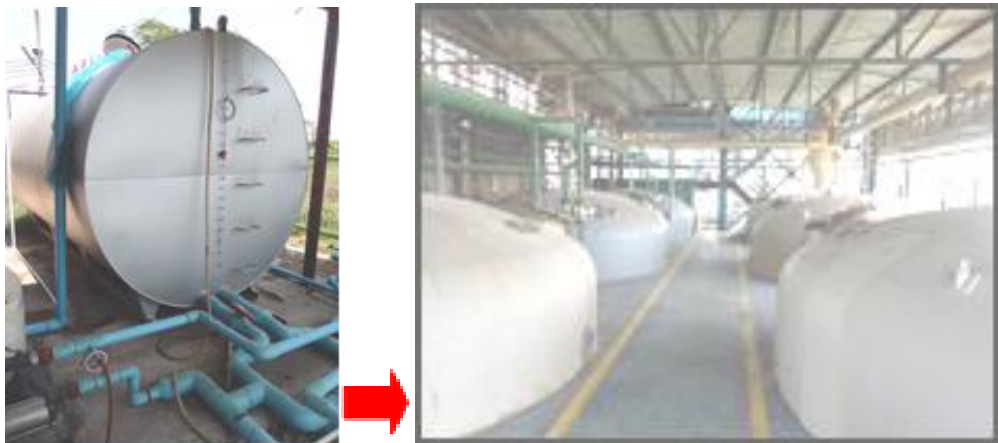
รูปที่ 11 การส่งน้ำจากถังเก็บน้ำเพื่อส่งเข้ากระบวนการผลิต (น้ำที่บำบัดแล้ว) ไปยังถังหมัก
