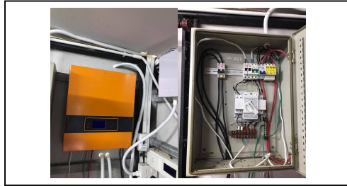
(ข) ระบบควบคุม
