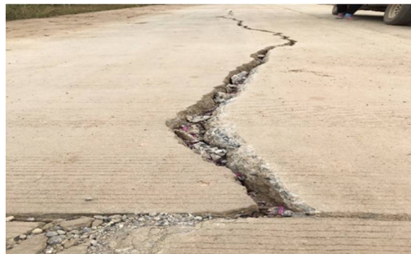
รูปที่ 2 รอยแตกร้าวของผิวทางคอนกรีตรอบอ่างเก็บน้ำ
